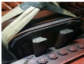
Figura 6: Desmontaje del polo averiado
